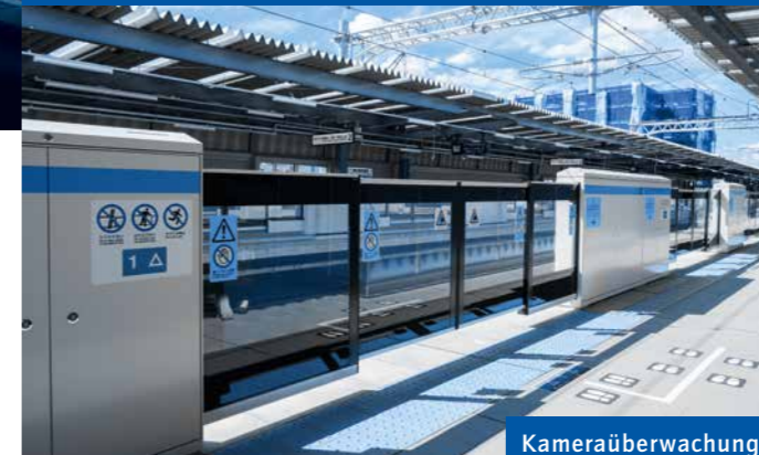
Schaltschränke / Control cabinet
